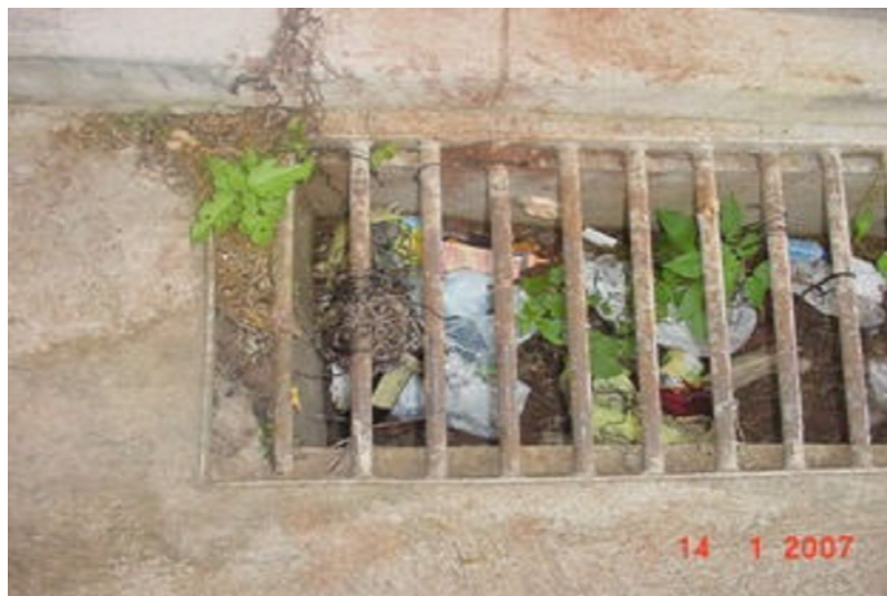
Figura 2 - Bueiro entupido com lixo.
