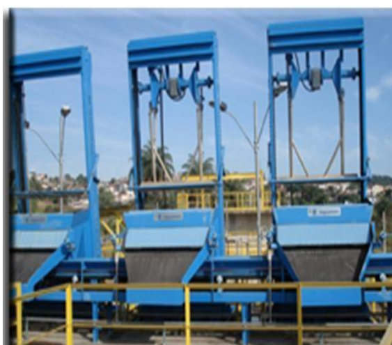
Figura 4 – Grade fina mecanizada
