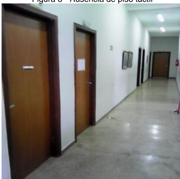
Figura 6 - Ausência de piso tátil
