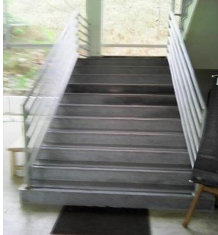
Figura 11 – Escada sem corrimão junto ao guarda corpo da escada
