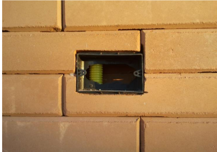
Figura 19: Exemplo de instalação elétrica parte externa
