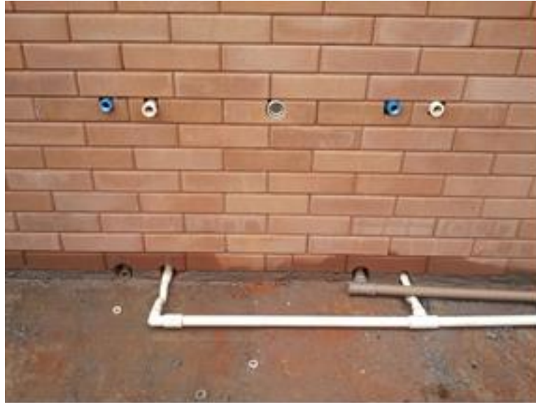
Figura 17: Exemplo de instalação hidráulica parte externa
