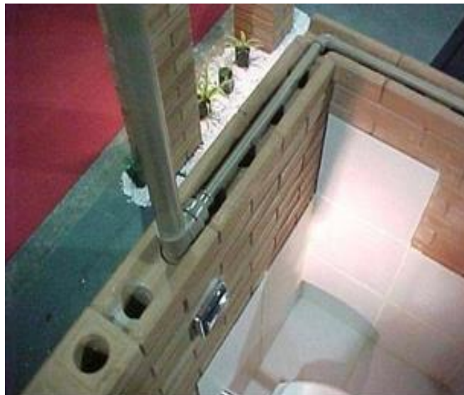
Figura 16: Exemplo de instalação hidráulica parte interna
