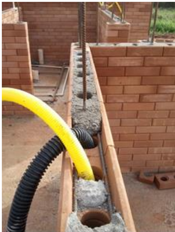
Figura 18: Exemplo de instalação elétrica parte interna
