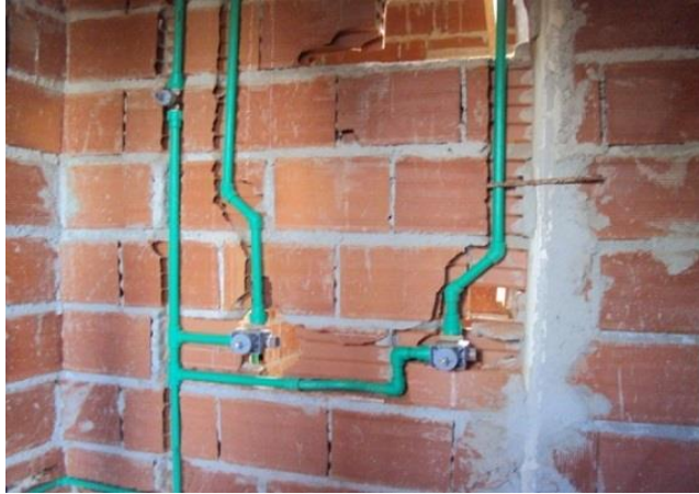
Figura 19: Tubulação de água quente e fria
