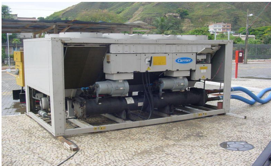
Figura 2 – Chiller de água gelada
