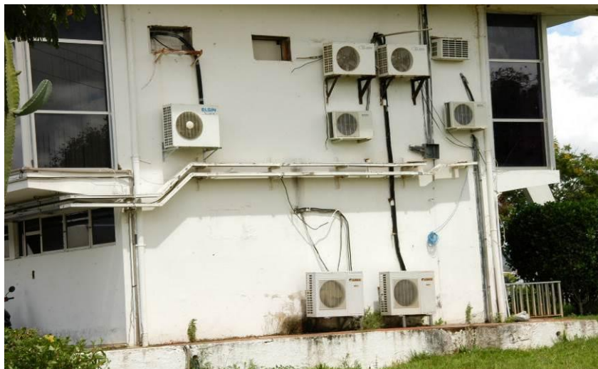
Figura 41 – Poluição visual gerada por condensadoras
