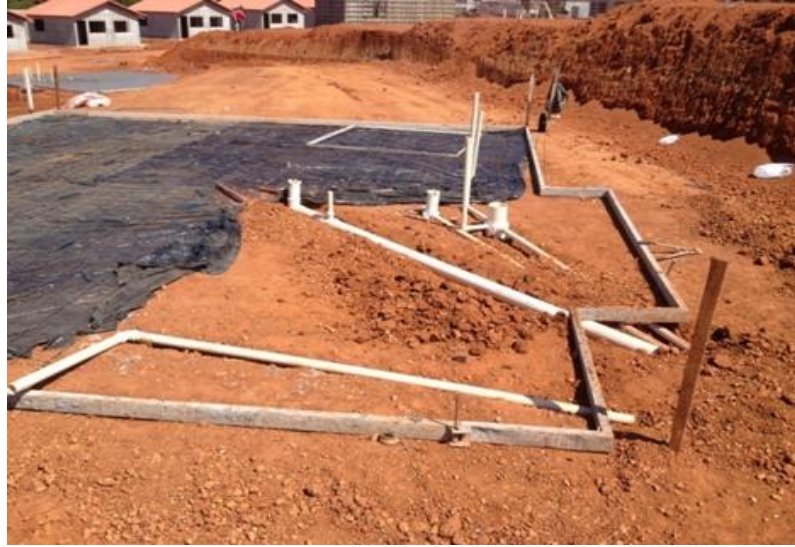
Fig. 6,7 e 8 - Após o gabarito do radier pronto passam-se as tubulações de instalações hidrossanitárias e em seguida coloca-se uma lona plástica para evitar a desidratação do concreto.
