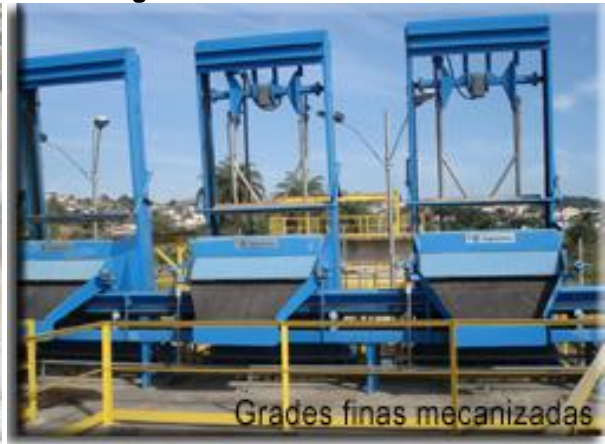
Figura 2 - Grade fina mecanizada
