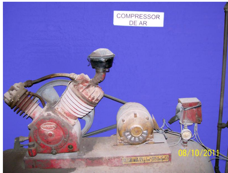
Figura 14 – Almojarifado (Compressor de Ar) - Depois
