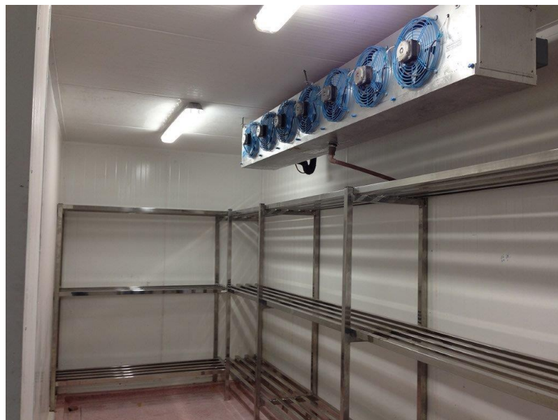
Figura 4 Evaporador Instalado em câmara frigorífica
