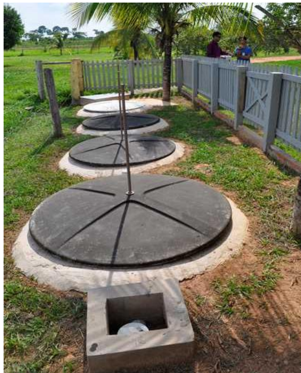
Figura 12 – Modelo de Fossa Séptica de Polietileno com as tampas pintadas de preto, evidenciando a caixa de inspeção e com a proteção(cerca) evitando danificar a fossa
