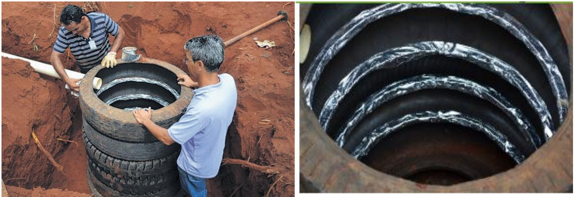
Figura 19 – Colocação dos módulos no local onde será construído a fossa séptica e detalhe interno da fita aluminizada
