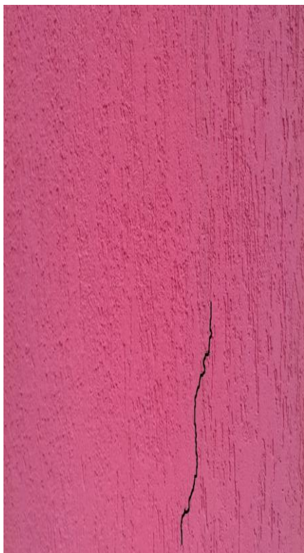
Fig. 12 – Trinca em parede interna
