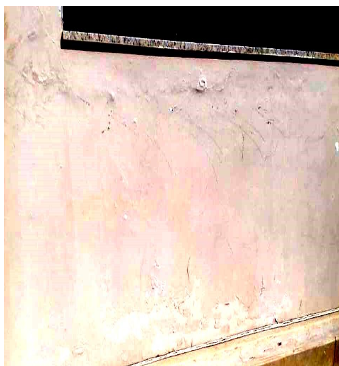
Fig. 14 – Umidade em parede externa
