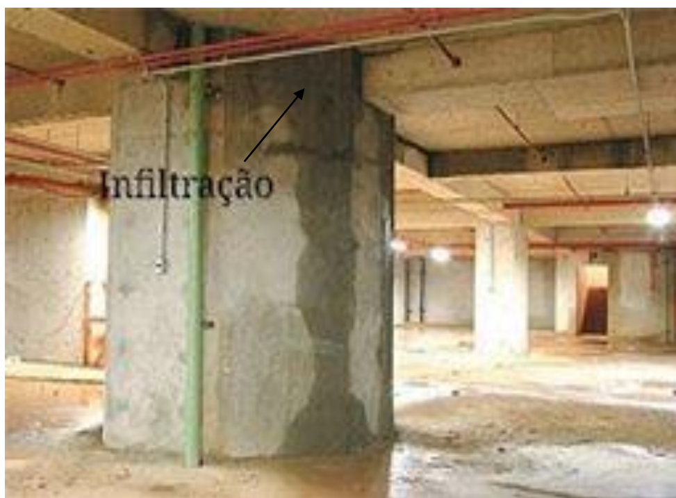
Fig. 4 – Infiltração no concreto
