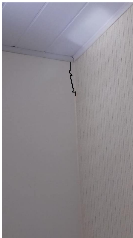
Fig. 13 – Trinca em parede externa
