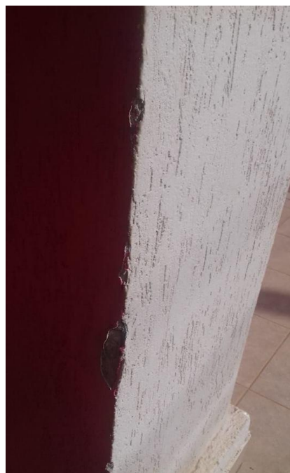
Fig. 11 – Deslocamento no pilar 2
