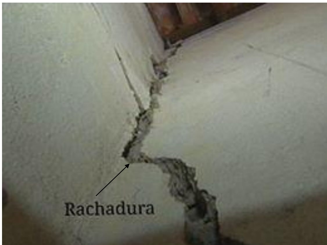
Fig. 6 – Rachadura no concreto
