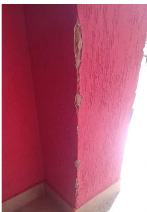
Fig. 10 – Deslocamento no pilar 1
