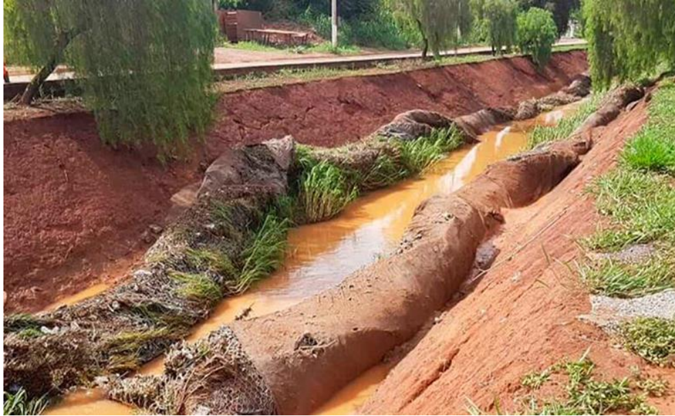
Figura 47– Danos ao leito de canalização do Córrego do Monjoloem 29/10/18
