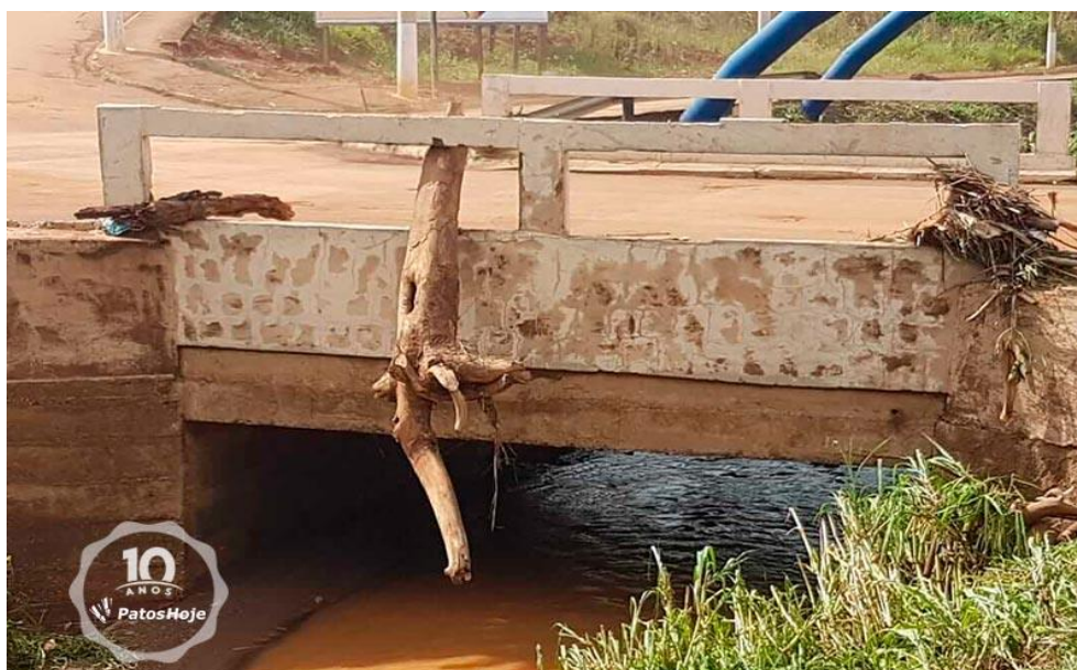
Figura 28 – Ponto de estrangulamento – cruzamento entre as avenidas Fátima Porto e Piauí
