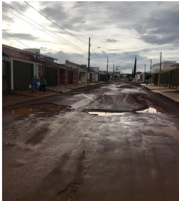
Figura 48 – Danos ao calçamento das ruas
