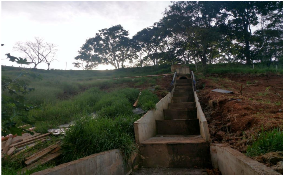
Figura 49 – Deposição de entulho
