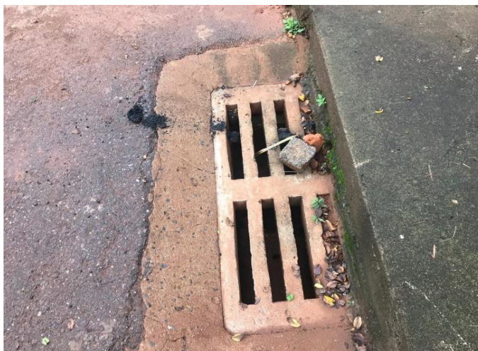
Figura 07 – Boca de lobo
