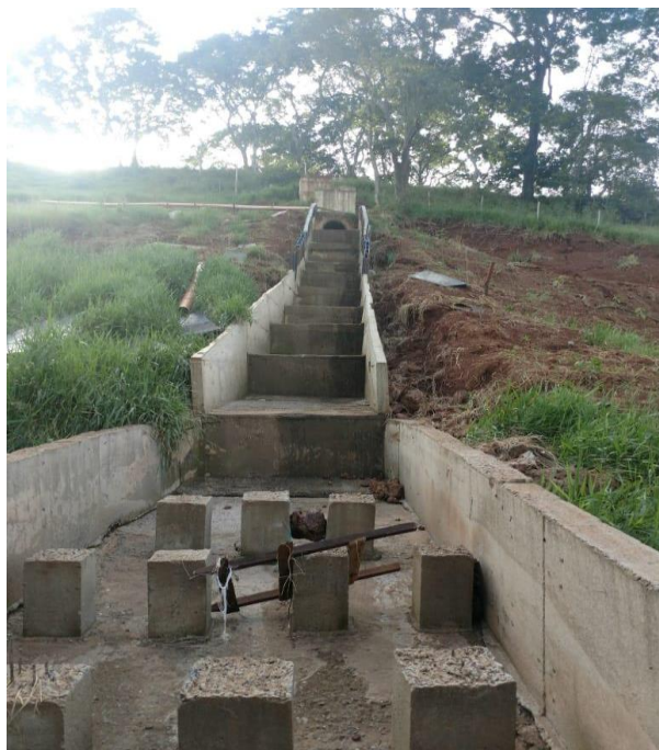
Figura 08 – Dissipador de energia
