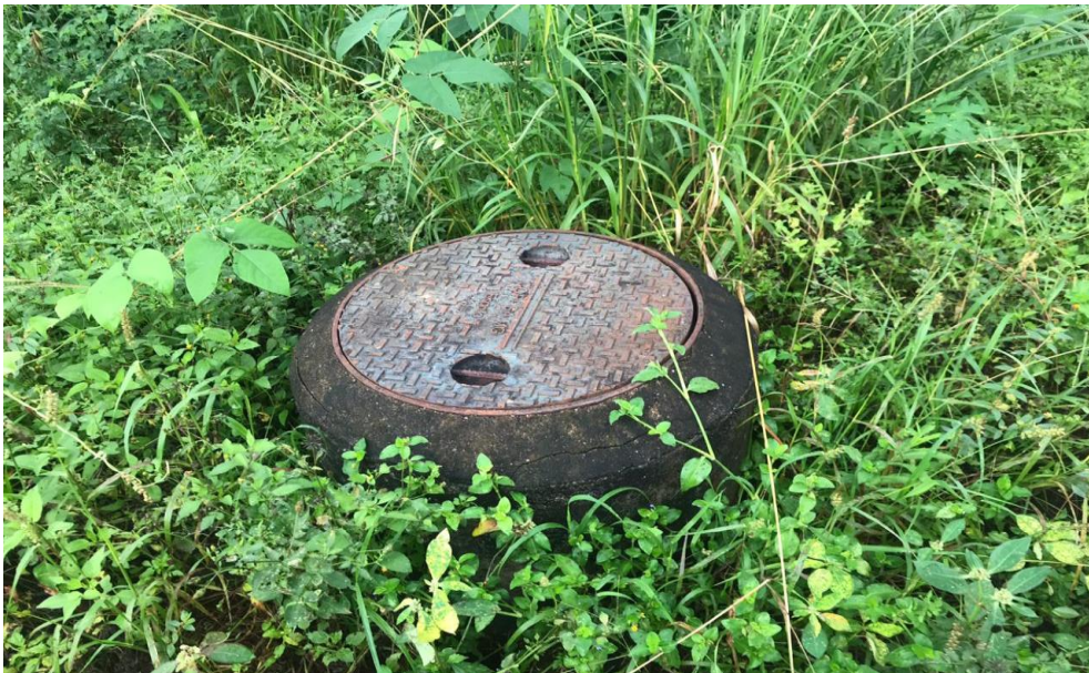
Figura 52 – Caixa de inspeção de esgoto
