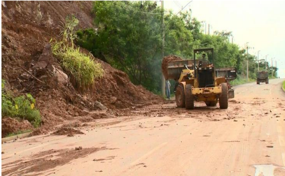
Figura 45 – Deslizamento de encosta na avenida Fátima Porto (início do período chuvoso em 13/11/18)
