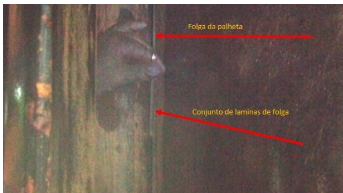
Figura 24. Palhetas do distribuidor da UHE Retiro Baixo (Fonte: Documentos Operacionais da UHE Retiro Baixo, 2019).
