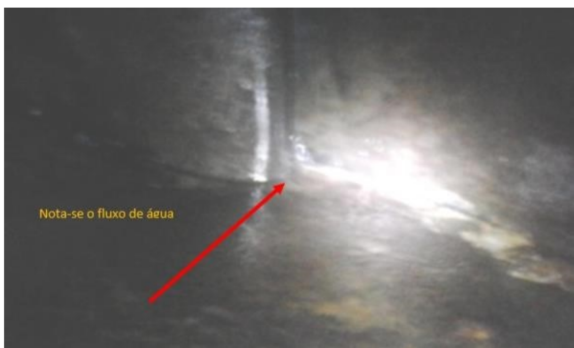
Figura 26. Fluxo de água nas falhas das palhetas do distribuidor da UHE Retiro Baixo (Fonte: Documentos Operacionais da UHE Retiro Baixo, 2019).
