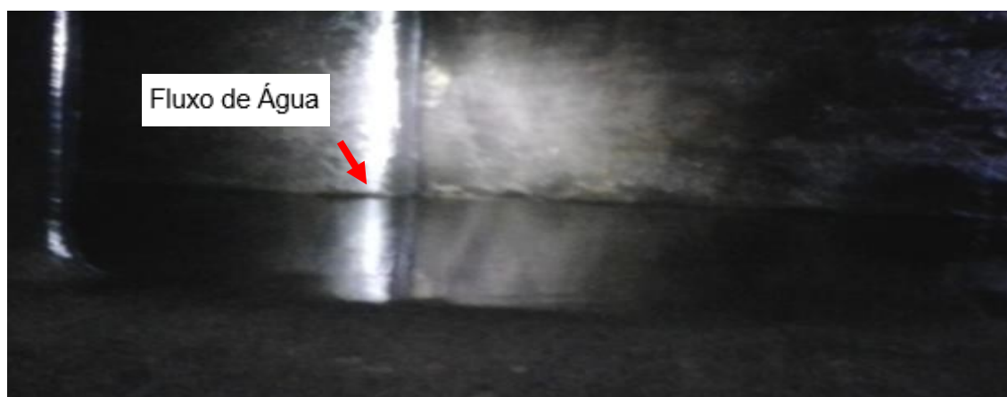
Figura 25. Fluxo de água nas falhas das palhetas do distribuidor da UHE Retiro Baixo (Fonte: Documentos Operacionais da UHE Retiro Baixo, 2019).
