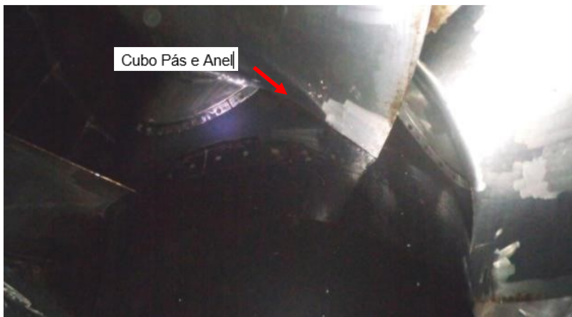
Figura 21. Pás, Cubo e Anel de Desgaste sem sinal de cavitação e oxidação (Fonte: Documentos Operacionais da UHE Retiro Baixo, 2019).
