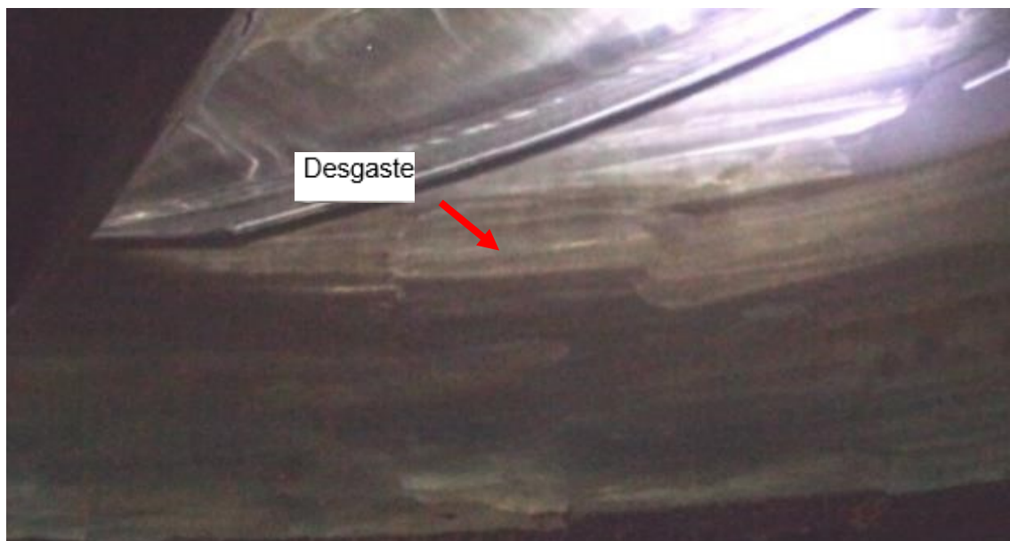
Figura 20. Pás, Cubo e Anel de Desgaste da Turbina da UHE Retiro Baixo (Fonte: Documentos Operacionais da UHE Retiro Baixo, 2019).
