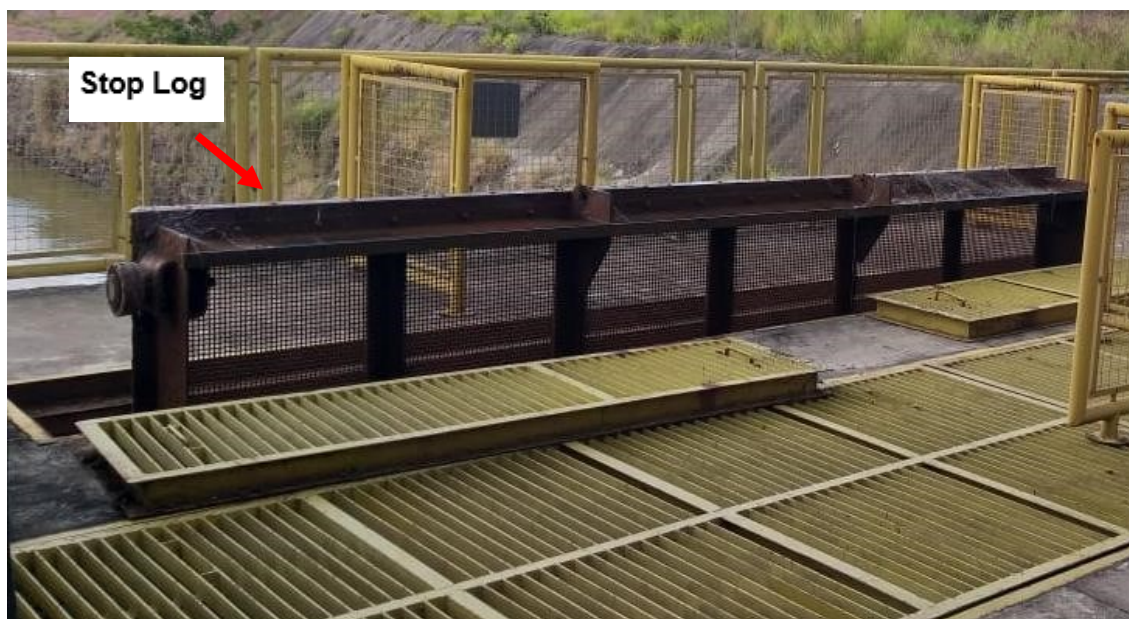
Figura 10. Comporta do Tubo de Sucção Retiro Baixo (Fonte: Documentos Operacionais da UHE Retiro Baixo, 2018).
