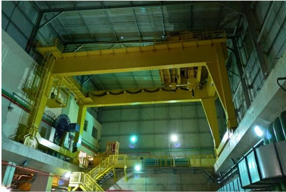
Figura 11. Pórtico Rolante da Casa de Força Retiro Baixo (Fonte: Documentos Operacionais da UHE Retiro Baixo, 2018).
